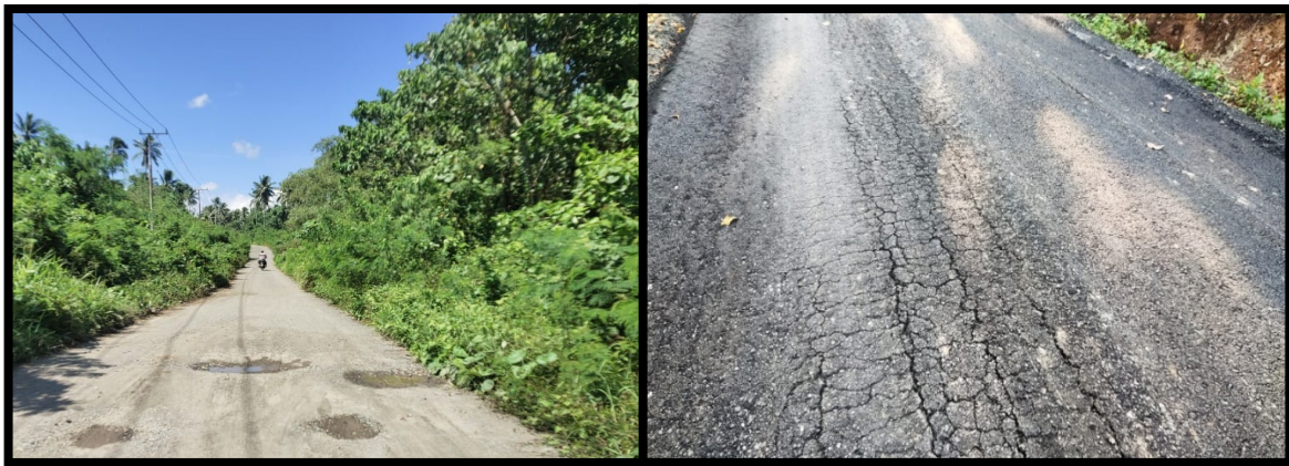
Gambar 3. Kerusakan jenis lubang dan retak kulit buaya di Kabupaten Pulau Morotai Sumber: (Shanin, 1994)
